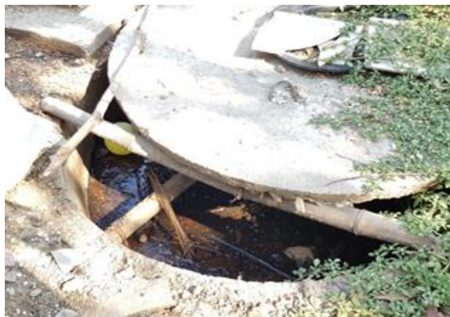
ที่มา: คณะผู้วิจัย รูปที่ 3-20 บ่อรวบรวมน้ำชะขยะ
